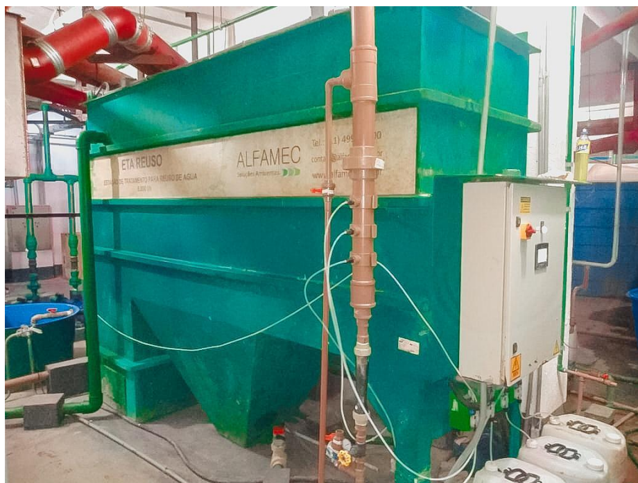
Figura 4.3 – ETA REÚSO 5,0 m 3 /h da marca ALFAMEC instalada no empreendimento.
