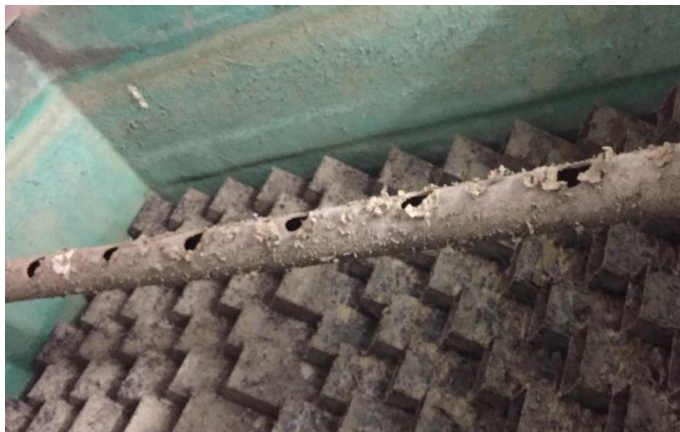
Figura 4.5 – Fotografia superior do decantador de alta taxa mostrando os elementos de decantação e o tubo de coleta de água decantada
