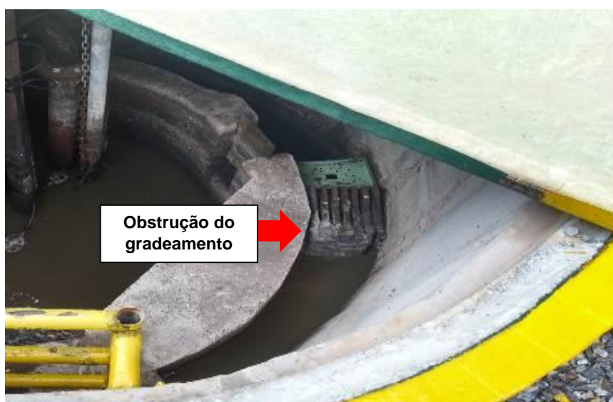
Figura 33 – Gradeamento da ETE, com acúmulo excessivo de resíduos.
