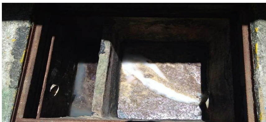
Figura 5 – Caixa de gordura da ETE Villa
