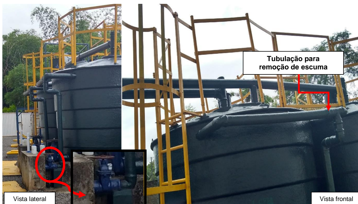
Figura 18 – Tubulação para remoção de espuma do RAn da ETE Villa
