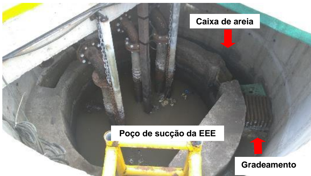
Figura 6 – Gradeamento e caixa de areia localizado ao redor do poço de sucção da estação elevatória de esgoto
