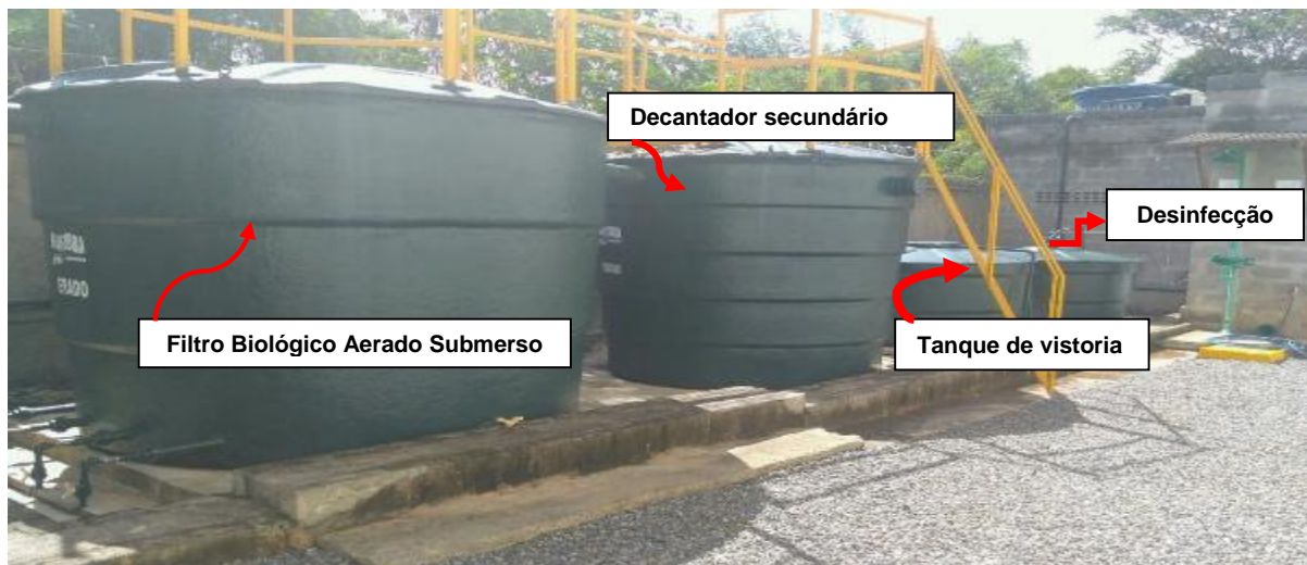
Figura 11 – Tratamento complementar dos reatores anaeróbios, composto por FBAS/FAn, decantador, tanque de vistoria e tanque de cloração
