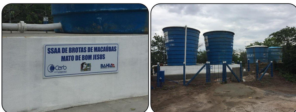
Figura 23 – Vista do Sistema Simplificado de Abastecimento de Água de Mata do Bom Jesus. Brotas de Macaúbas, Bahia. 2018
